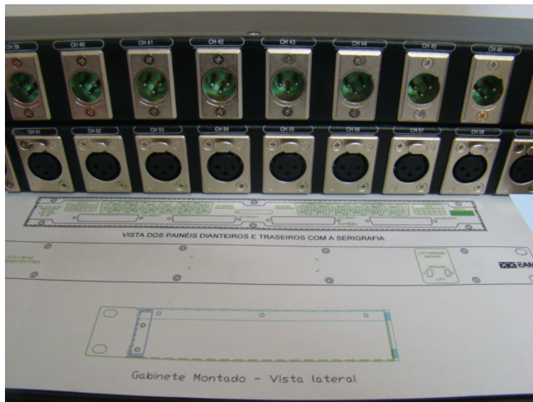
Vista Parcial Frontal dos painéis XLR macho e fêmea com 12 circuitos
